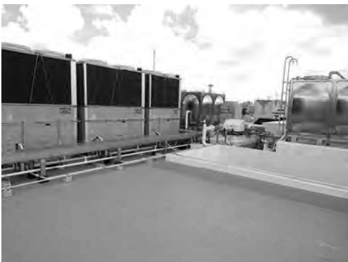
P H階 設備スペース
