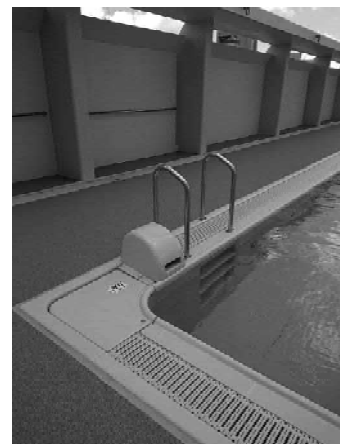
補給水吐水口
