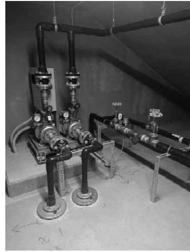
中水用揚水ポンプ
