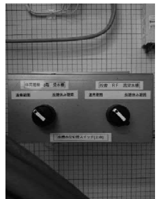
水位切替スイッチ (事務室に設置)
