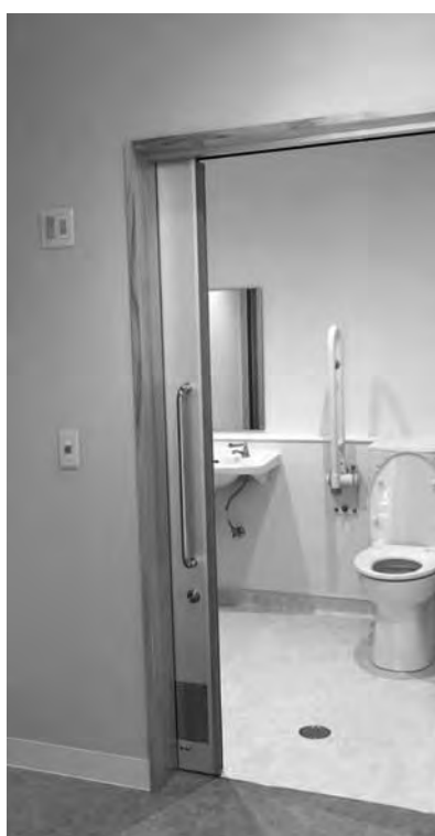
トイレ呼出設備 表示灯 復旧釦
