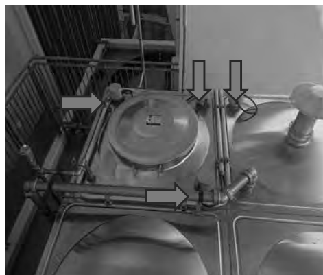
受水槽水位用电極× 4 (矢印)
