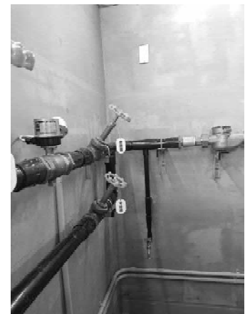
補給水用電動弁
